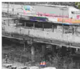
A14 il viadotto crollato
