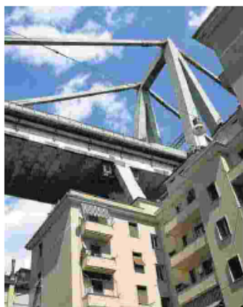
Il moncone del ponte Morandi di Genova
