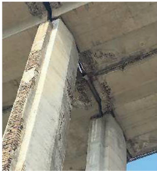
Uno dei piloni autostradali danneggiati
