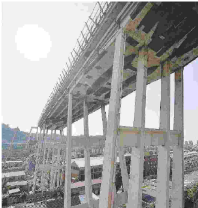
Il lato ovest Un troncone del ponte Morandi, crollato il 14 agosto Ansa
